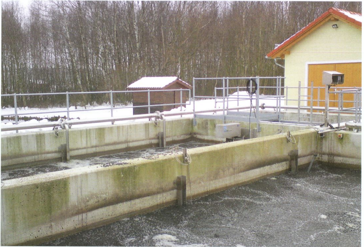
Die Luft zur Verwirbelung erzeugen 2 Drehkolbengebläse. Fotos: EvU
